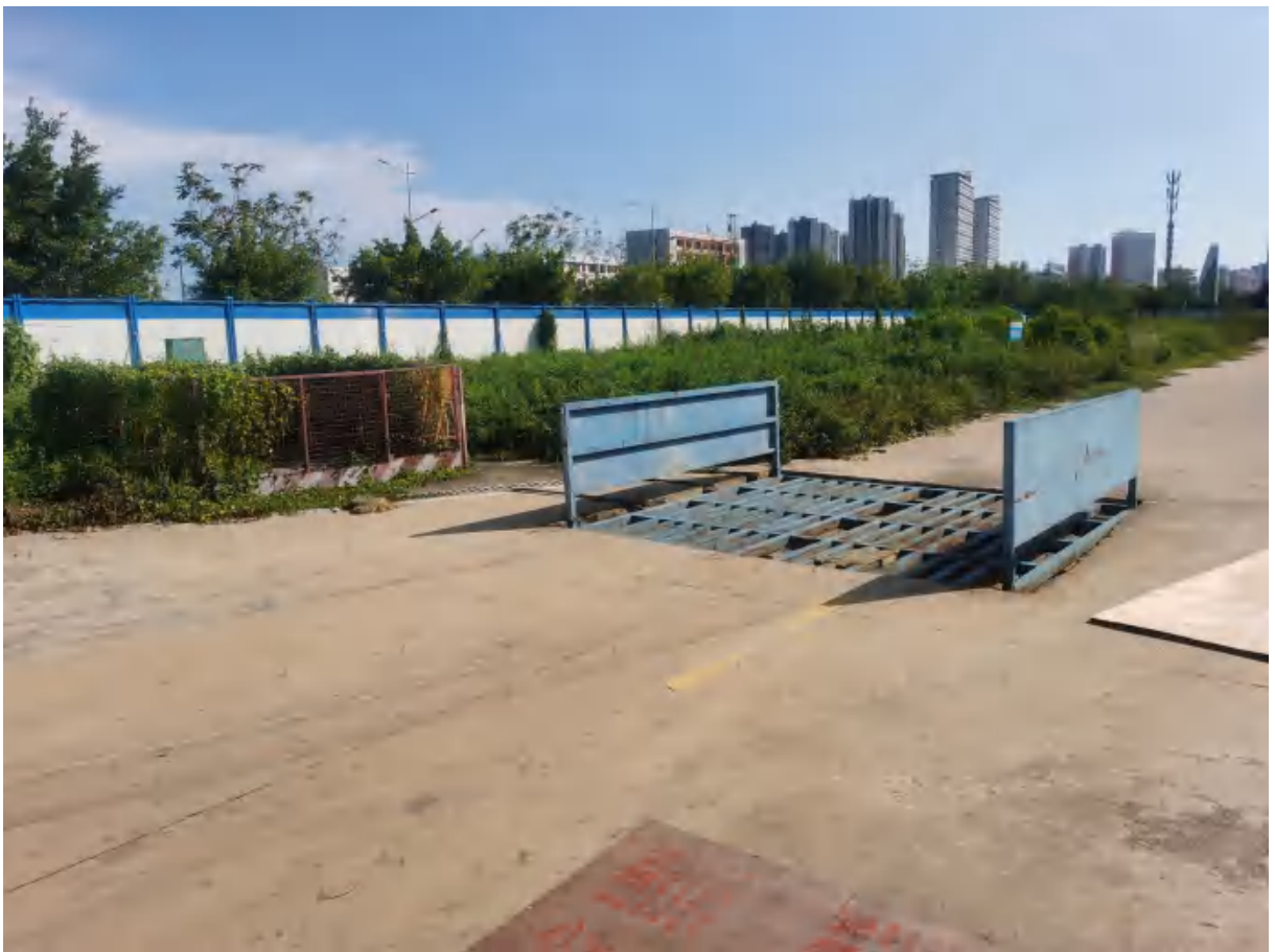
项目已布设洗车池现状 (2023年7月5日拍摄)
